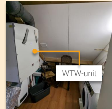
Ventilatie warmte-terugwinning op zolder
